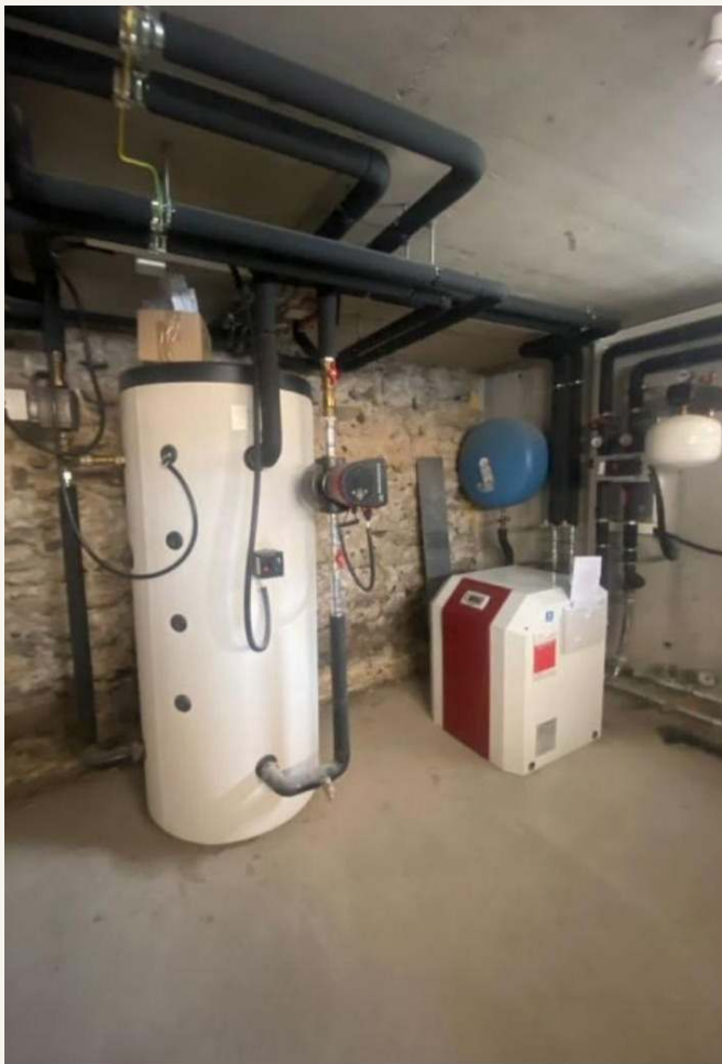
Local technique · pompe à chaleur
